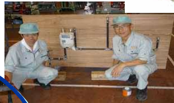
LPガス配管
