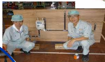
LPガス配管
