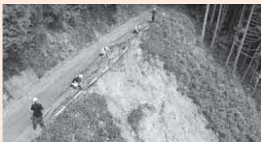
被災した町道中屋水谷線
