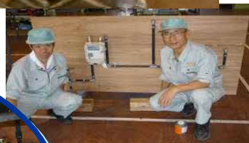
LPガス配管
