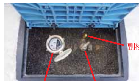
水道メーター
