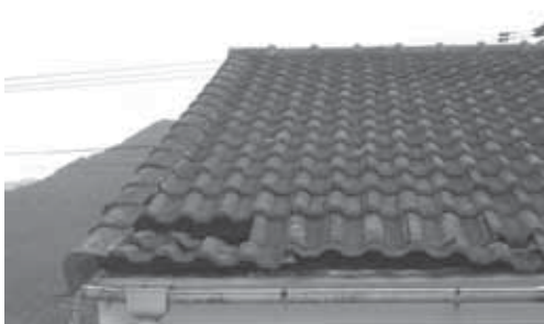
第15分団中ノ番班詰所の修繕が必要な屋根
