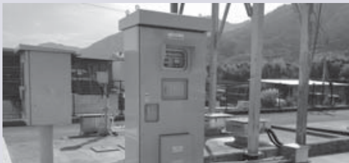
改修された紫外線消毒装置
