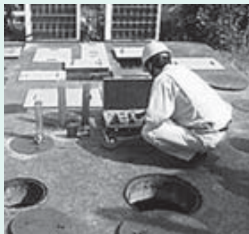
合併浄化槽の点検
