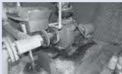
修繕が必要な給水管
