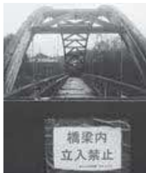
通行止めのあいあい橋
