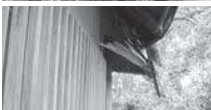
破損した建屋
