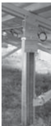
太陽光発電パネルの支柱
