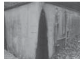
漏水する貯水槽
