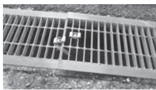
修繕するグレーチング
