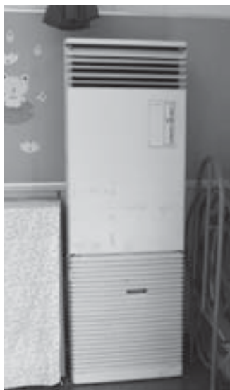
故障したエアコン
