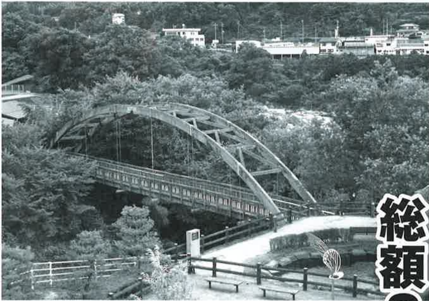
老朽化したあいあい橋
