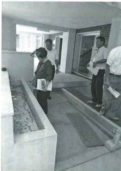
加茂小学校の老朽化した手洗い台
