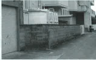
三庄小学校のブロック塀
