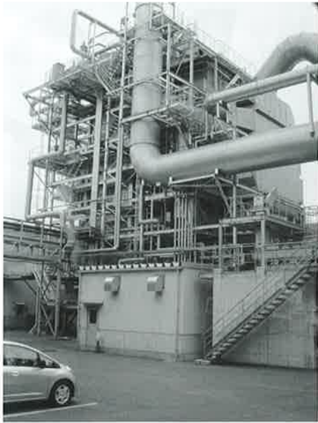
バイオマス発電所
