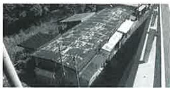
屋根の修繕が待たれる住宅
