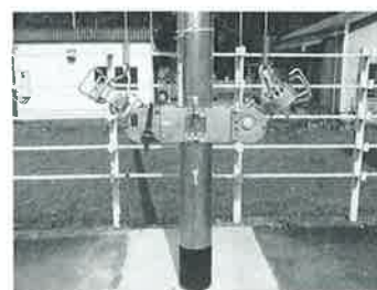
ホース吊り下げ塔手動ウインチ
