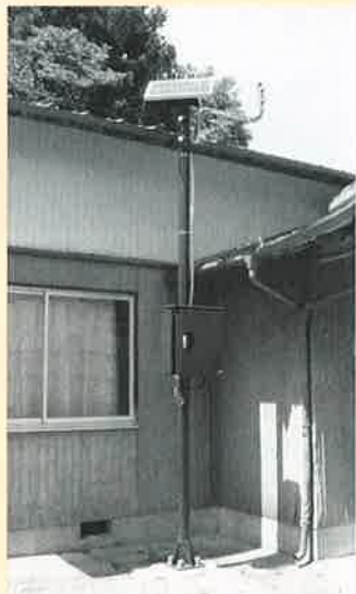
大藤地区に設置された防災灯
