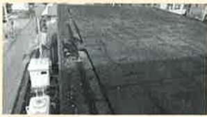
修繕が必要な三庄小学校校舎の屋上
