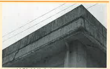
外壁が落ちたランチルーム
