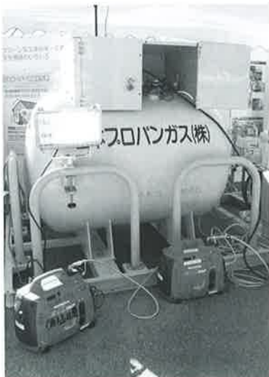
プロパンガス発電機
