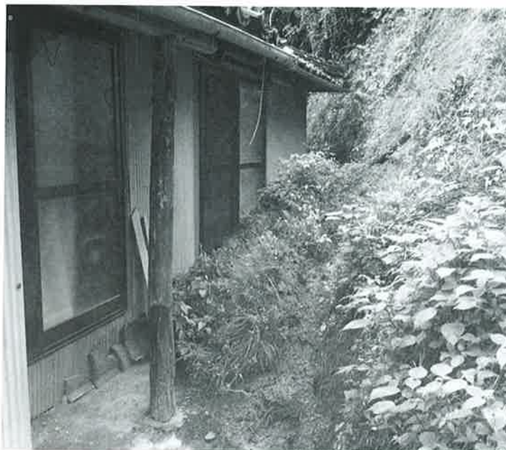
豪雨で裏山が崩れた家
