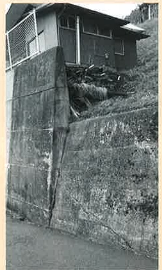
改修に必要がある加茂山擁壁
