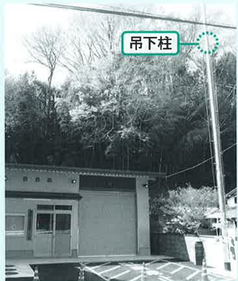
16分団に設置された吊下柱（写真右端）
