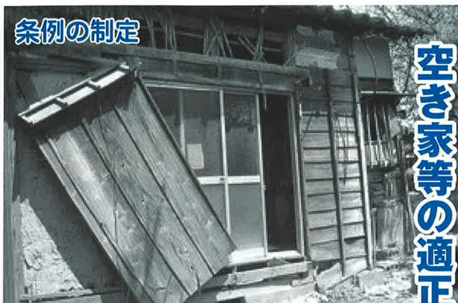
老朽化して危険性の高い空き家（例）
