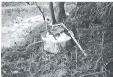
破損した水源タンク
