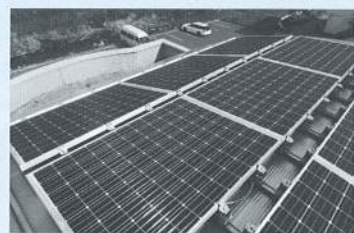
本団詰所に設置されたソーラーパネル
