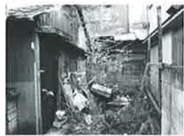
老朽化して危険な空き家
