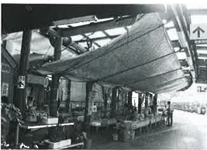
雨漏りがするオアシス(農産物直売所)
