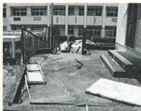
修理が必要なフェンス
