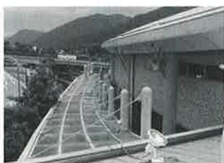
オアシス屋根の雨漏り箇所
