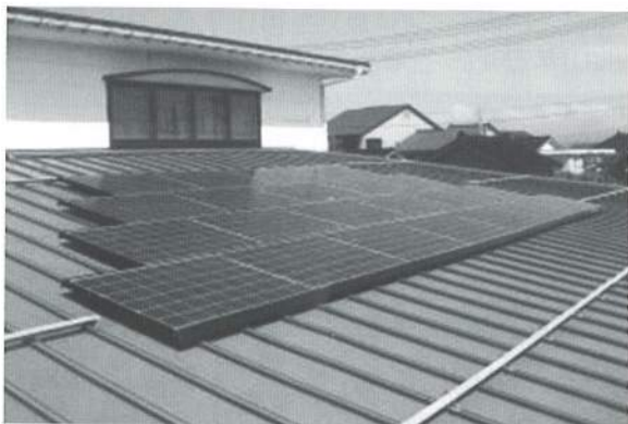
新潟県上越市での太陽光発電設置例
