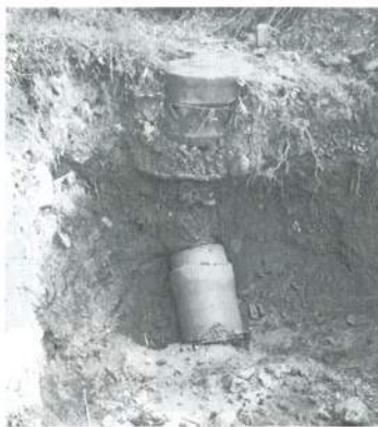
破損した灌漑排水パイプ
