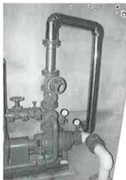
消火栓ポンプ
