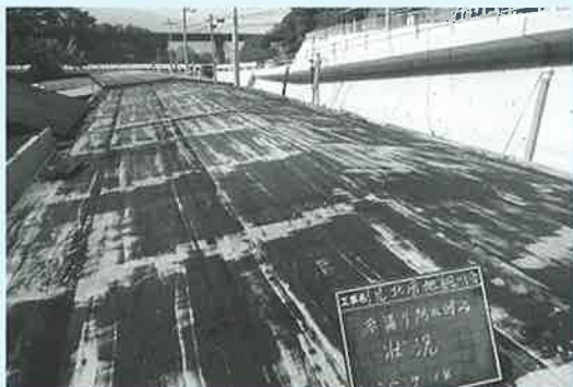
修繕が待たれる屋根
