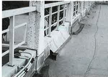
昼間小学校北校舎屋上の漏水箇所
