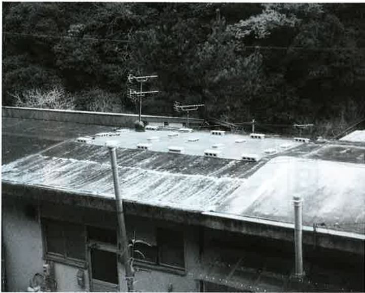
修繕を待つ町営住宅
