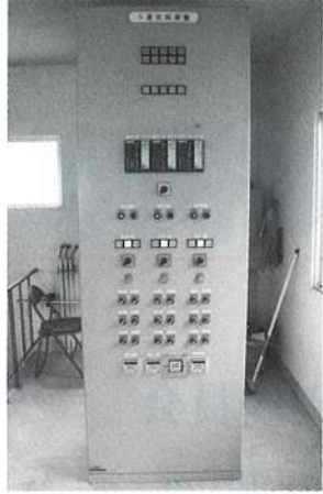
簡易水道 第2浄水場 損失水頭指示計
