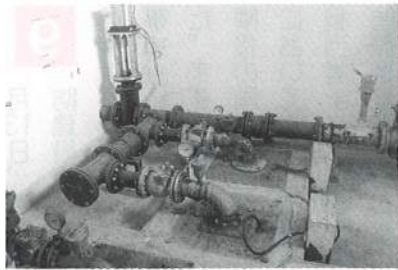
簡易水道 第2浄水場 水中ポンプ
