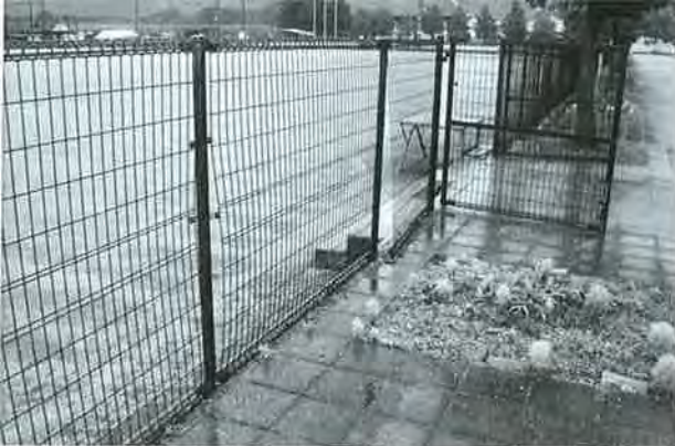
修繕が必要なフェンス
