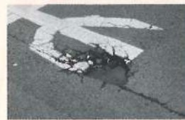
穴が開いた町道
