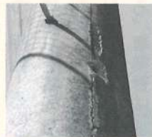
ひびが入った支柱
