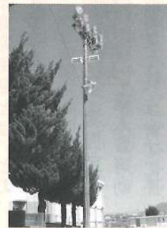
老朽化したコンクリート支柱照明設備
