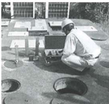
合併浄化槽の点検
