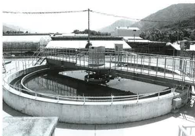
2基目の浄化処理施設
