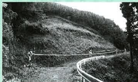
被災した町道法市内野線
