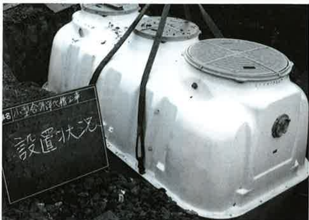
合併処理浄化槽
