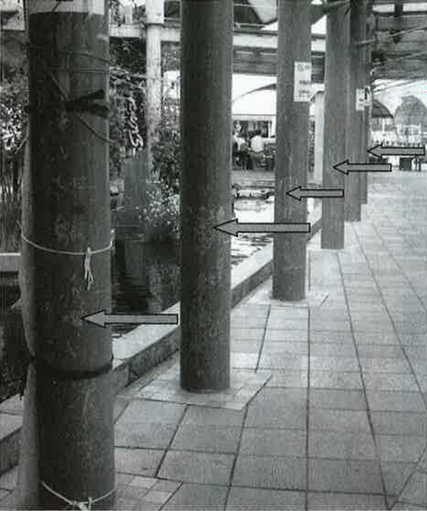
塗装の剥がれた鉄骨柱
