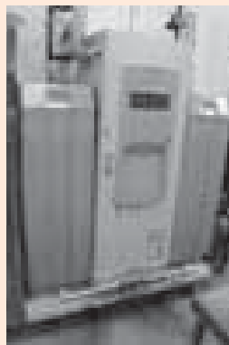
故障した電解水生成装置
