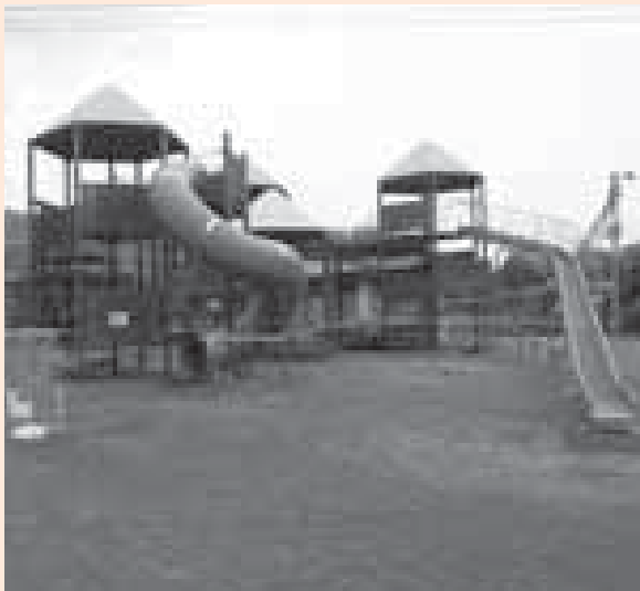
使用禁止となったオアシスの大型遊具
